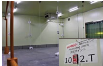
薬品庫1(+15°C~+25°C): 97㎡ 薬品庫2(+2°C~+8°C): 44㎡ 取り扱い貨物: 薬品等
